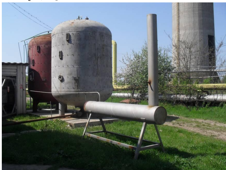
Figura 46. Vedere din față a instalației
