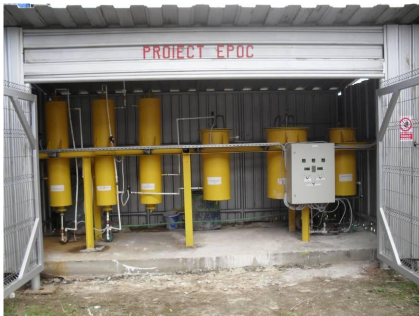
Figura 47. Vedere centrală a sistemului de filtrare și control
