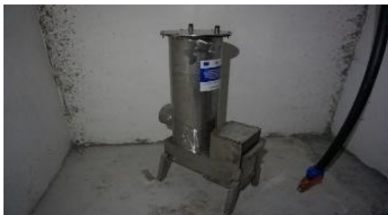
Figura 43. Centrala termică pilot (fără automatizare)
